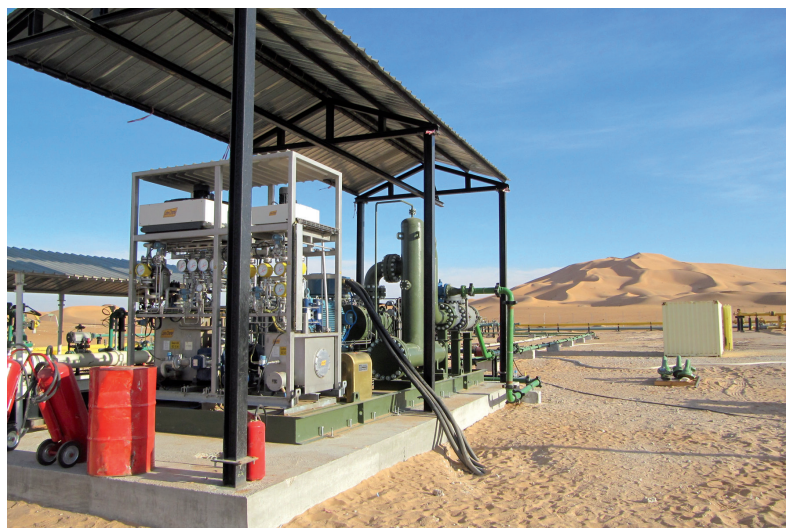
Abb. 2: Multiphasenpumpe in Algerien
