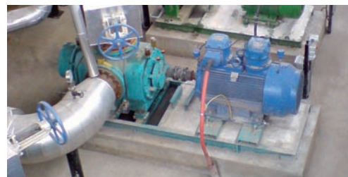
5 Зачистной насос для сырой нефти Leistritz L4MG
