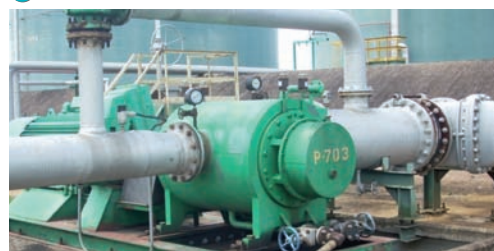
6 Насос перекачивания тяжелой топливной нефти Leistritz L4MG
