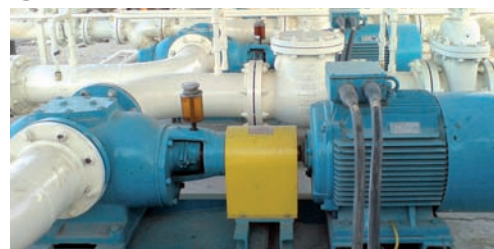
2 Насос откачивания тяжелой топливной нефти Leistritz L2NG
