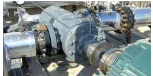
4 Pompa przeładunkowa L3MG
