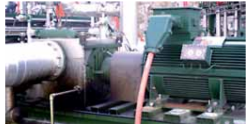
1 Pompa rozładunkowa L4MG
