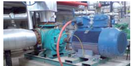
1 7 Pompa rozładunkowa i ładunkowa L4NG
