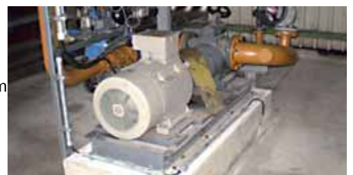
5 Pompa do czyszczenia zbiornika L4NG
