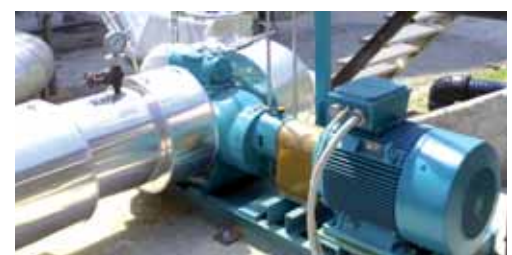
6 Pompa do obiegu bituminu L2NG
