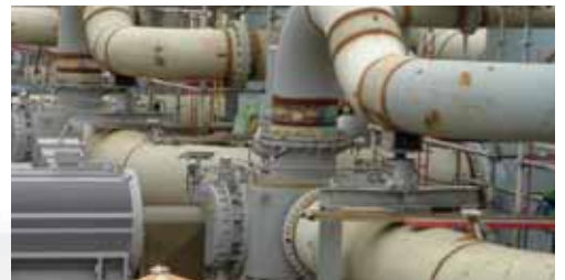
3 Pompa ładunkowa i przeładunkowa L4NG
