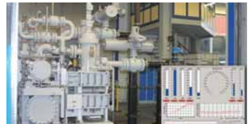
Instalacja pompy wielofazowej Leistritz na stanowisku testowym
