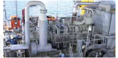
1 Wielofazowa pompa L4HK na platformie morskiej
