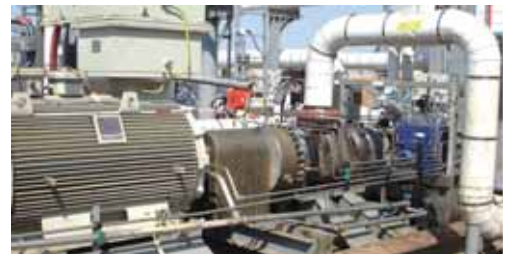
2 Pompa do rozruchu rurociągu L4HK
