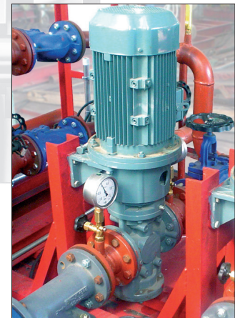
3 4 10 11 Pompa przeładunkowa i zasilająca separator PO/ON L3NG
