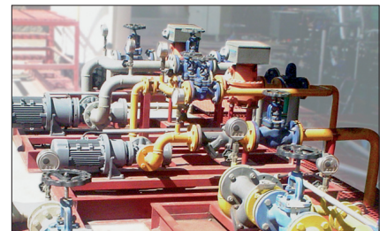
1 2 Pompa przeładunkowa OS oraz zasilająca separator L3NG
