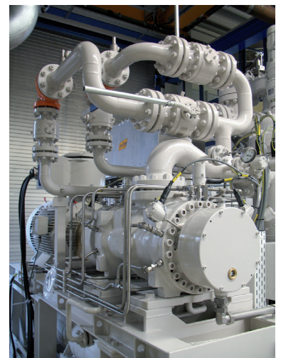
Abb. 5 und 6: Multiphasenpumpen-Aggregat auf Multiphasenpumpen-Prüfstand
