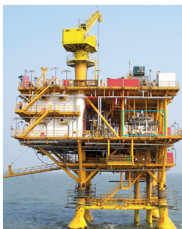
Abb. 7: Pumpengestell, Steuercontainer und Transformator
