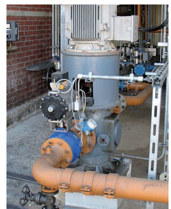
Leistriz PUR-Pumpe L3MG
