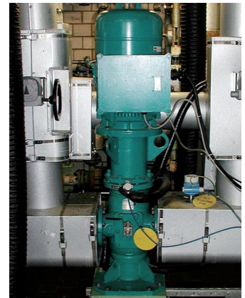
Leistriz Batch-Pumpe L2NG
