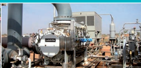
Установка с мультифазным насосом Leistritz на нефтяном месторождении Центральной Африки Q = 395 - 1000 \text{ м}^3/\text{ч} \cdot \Delta p = 7,3 - 56,2 \text{ бар} \cdot GVF = 56 \%
