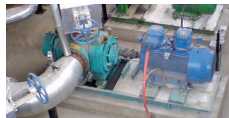
4 Зачистной насос L4MG
