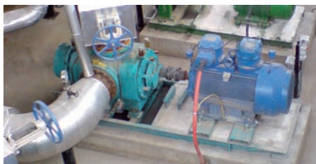
4 Насос L3HF уплотнительного масла
