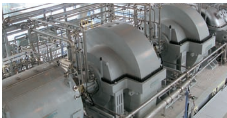
1 Насос L3 для смазочного масла и масла уплотнения компрессора
