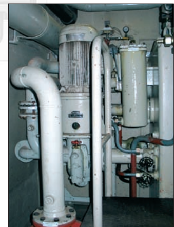
3 Main LO Pump L2NG
